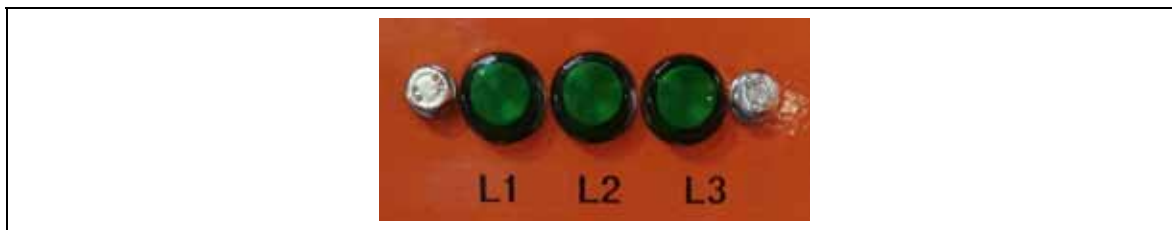
Figur 48: eksempel på faseindikatorlamper
